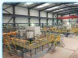
天然气长输管线压缩机组
